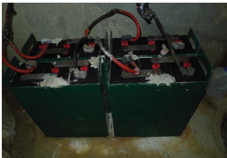
شکل ۱۲۵- شرایط نامناسب باتری‌ها
