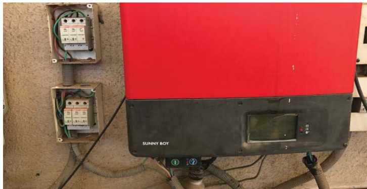
شکل ۸۶- شل بودن کاندویت‌ها و کابل‌های اینورتر
