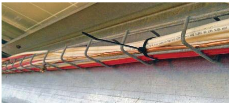
شکل ۱۱۳- کابل‌ها بسته شده توسط بست کمربندی
