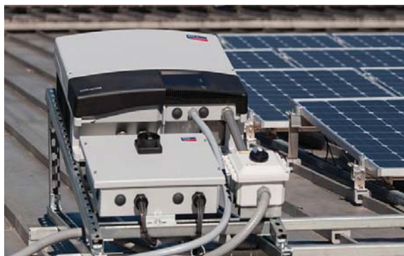
شکل ۸۴- اینورتر نصب شده بدون سایه بان
