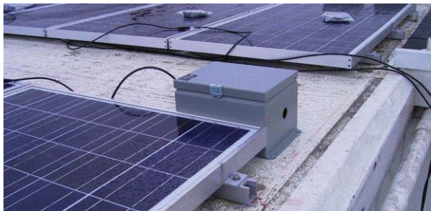
شکل ۱۰۰- مسیر کابل اشتباه
