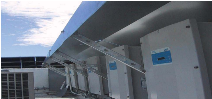
شکل ۸۵- اینورتر نصب شده زیر سایه بان
