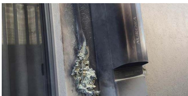
شکل ۸۲- آسیب دیدگی اینورتر ناشی از سوختن (سوختگی خارجی)
